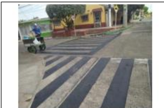
IMPRIMACION DE LAS SEÑALES HORIZONTALES EXISTENTES-calle 59 y carrera 36 F instituto 26 se marzo sede D: Alcázar
